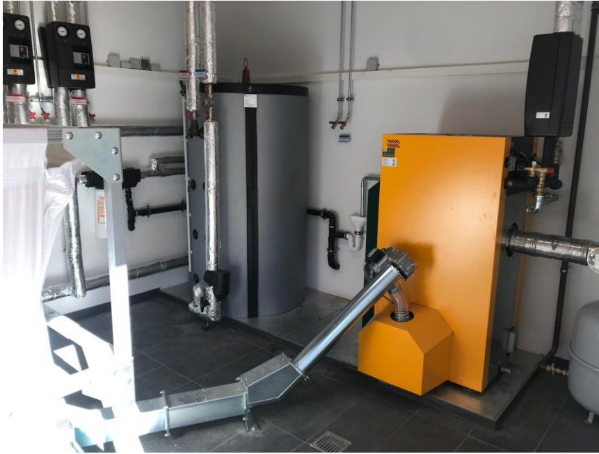
Abbildung 2: Vergleichbare Anlage in einem Feuerwehrhaus
